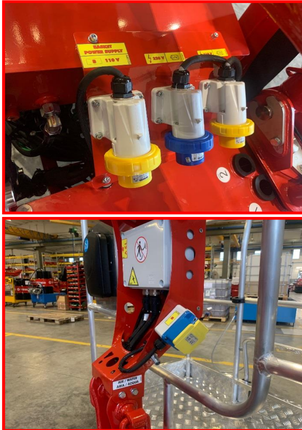
Figure 7b: prises électriques pour double alimentation.
